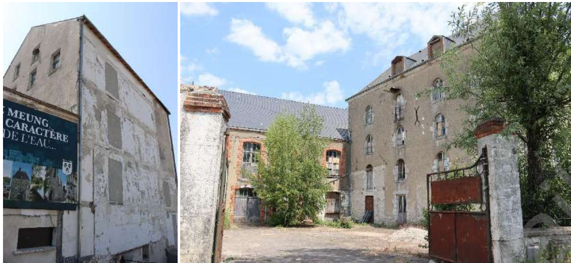
Photo 19. Des bâtis dégradés au fil du temps
